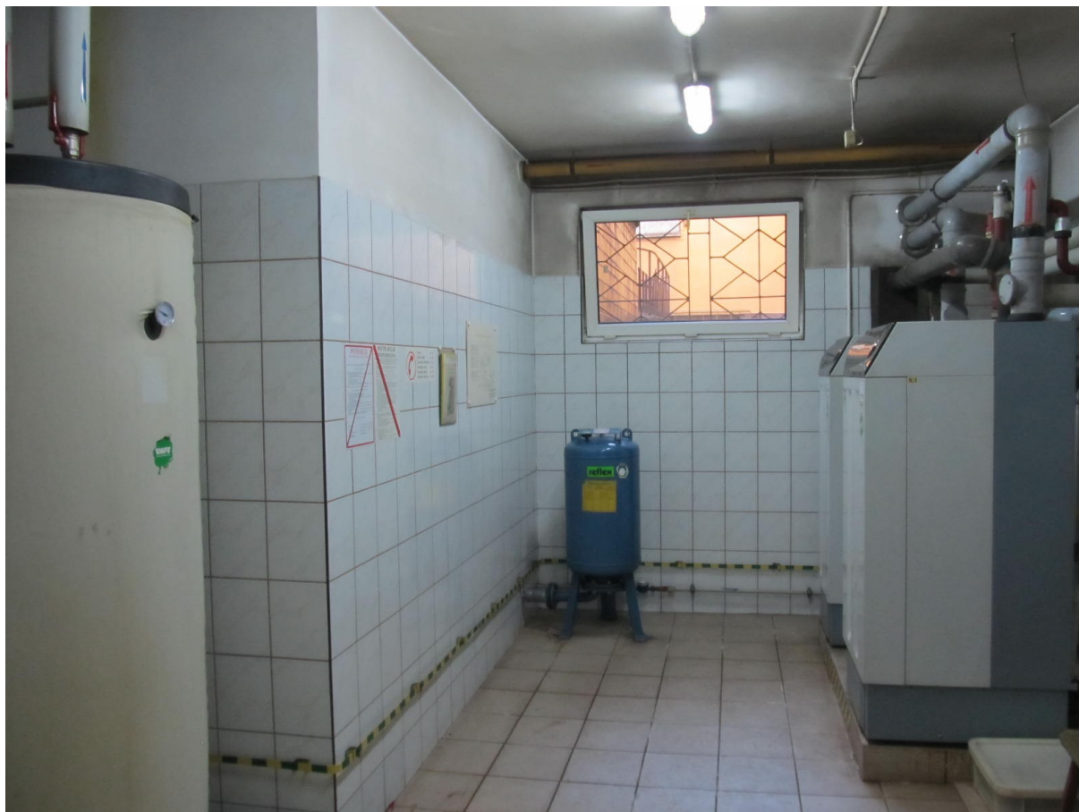
Wojewódzki Szpital Psychiatryczny w Andrychowie – Segment CD – istniejąca kotłownia
