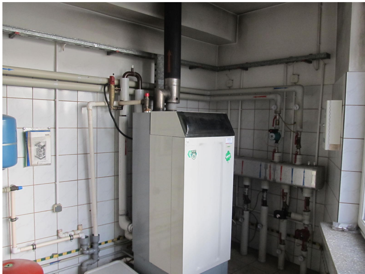
Wojewódzki Szpital Psychiatryczny w Andrychowie – Segment B – istniejąca kotłownia
