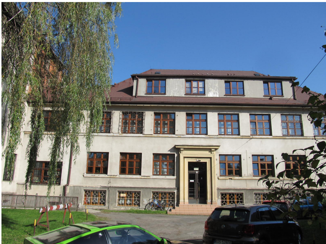
Wojewódzki Szpital Psychiatryczny w Andrychowie – Segment A cz. II – istniejąca elewacja niedocieplona
