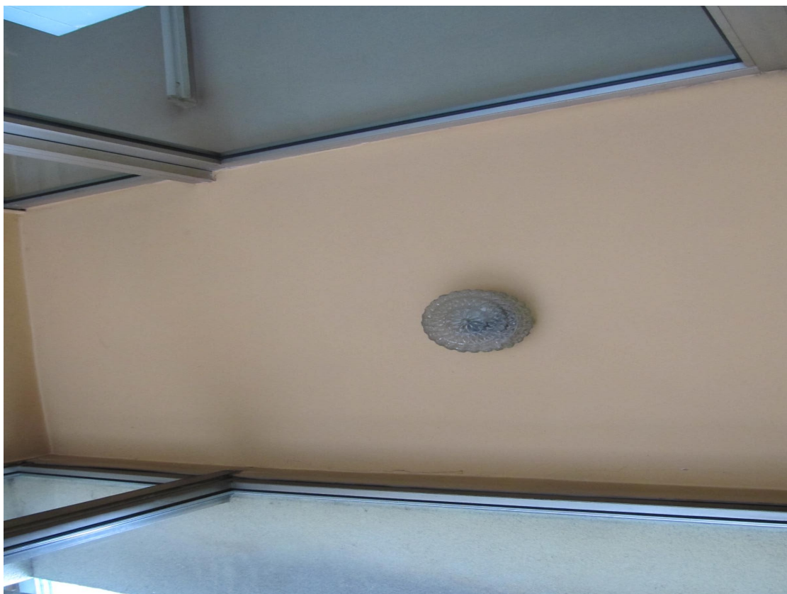
Wojewódzki Szpital Psychiatryczny w Andrychowie – Segment A – istniejące oświetlenie
