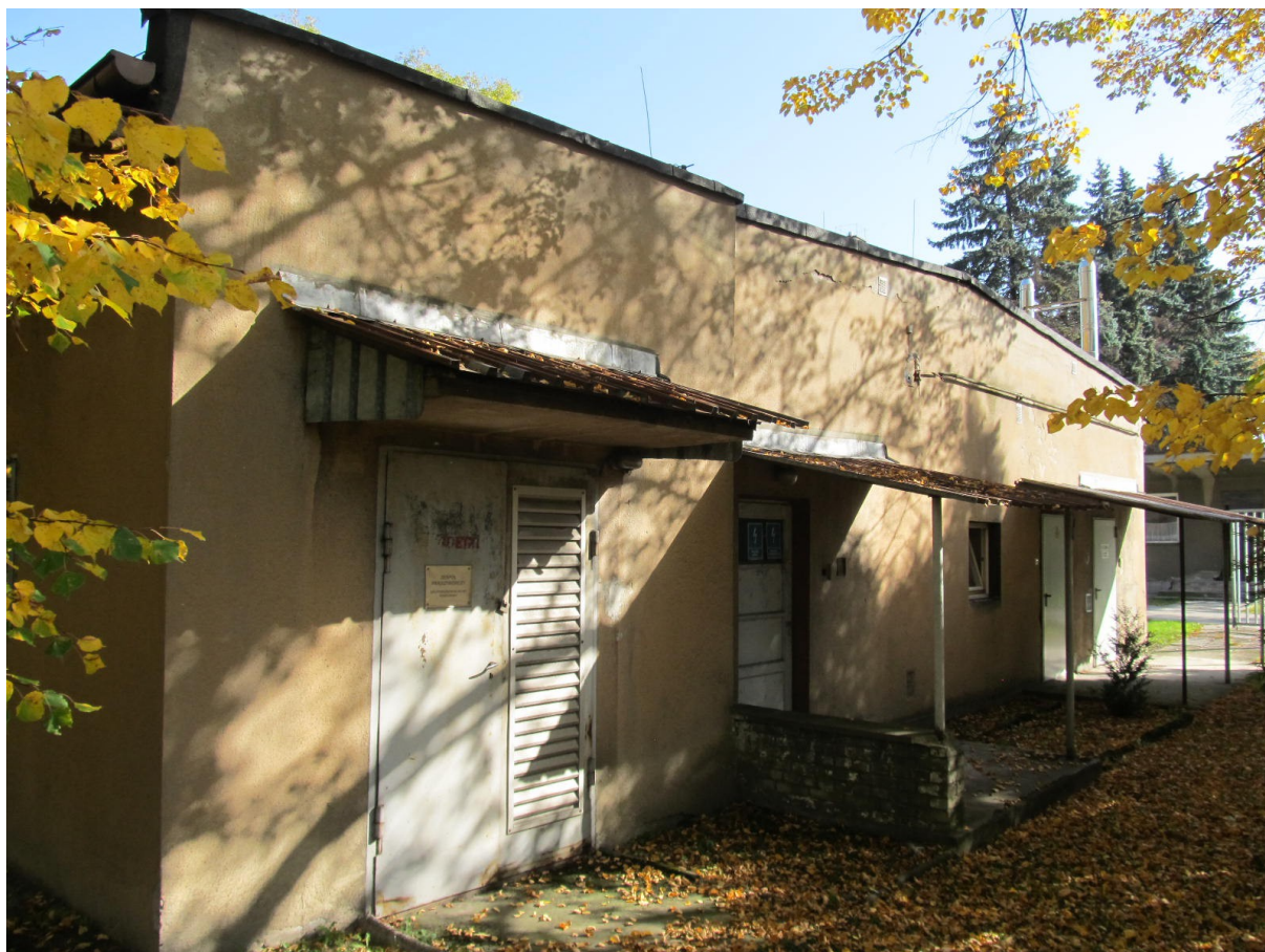
Wojewódzki Szpital Psychiatryczny w Andrychowie – Pralnia – istniejąca elewacja niedocieplona
