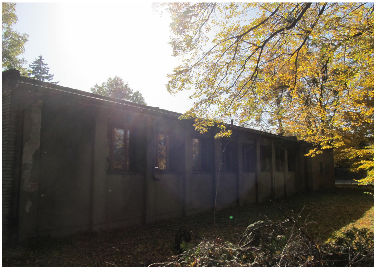
Wojewódzki Szpital Psychiatryczny w Andrychowie – Pralnia – istniejąca elewacja niedocieplona
