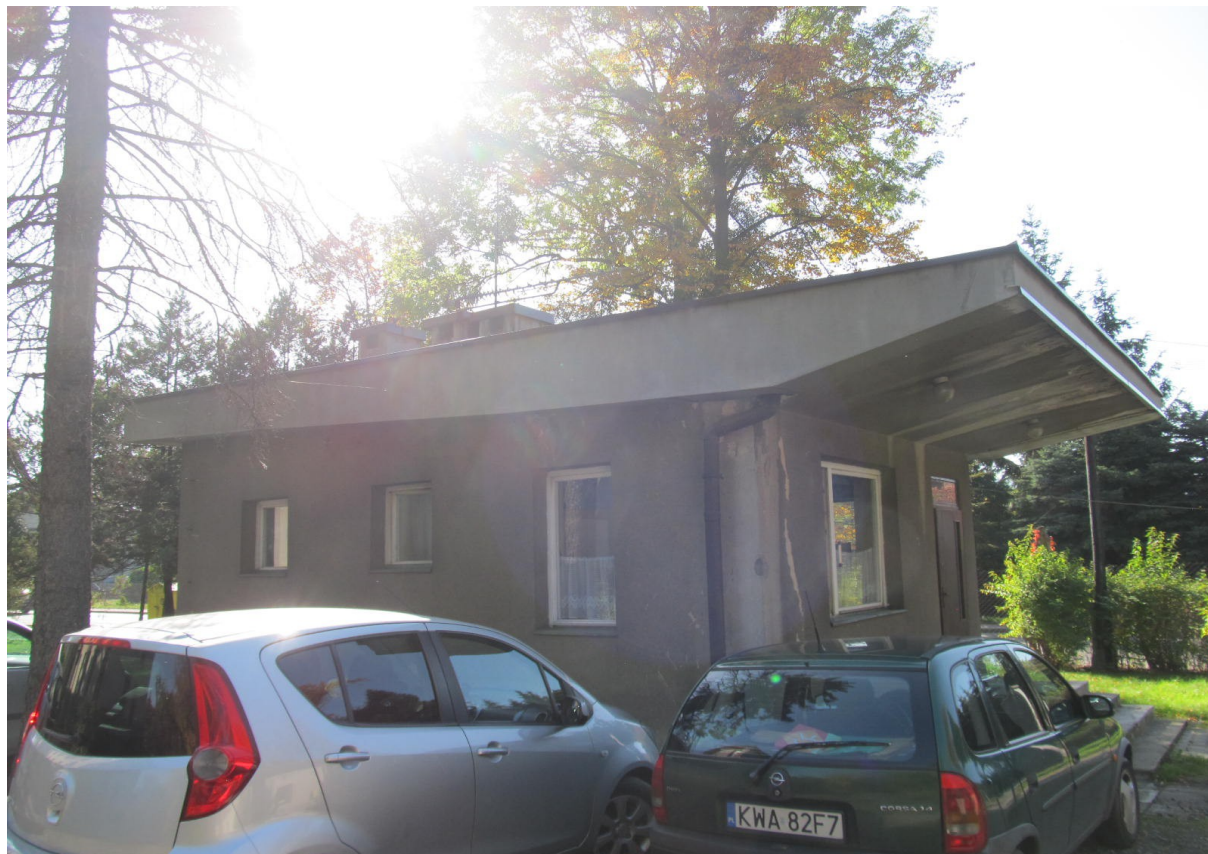
Wojewódzki Szpital Psychiatryczny w Andrychowie – Portiernia – istniejąca elewacja niedocieplona
