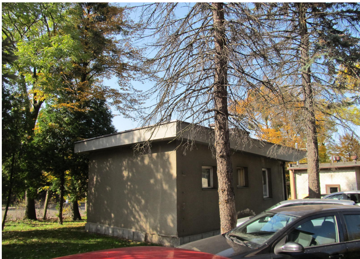
Wojewódzki Szpital Psychiatryczny w Andrychowie – Portiernia – istniejąca elewacja niedociepłona
